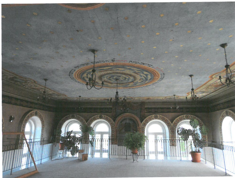
Przed remontem, widoczny jest popękany strop
